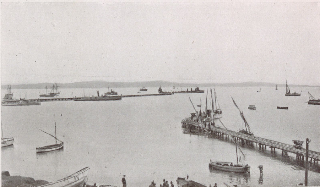
Durazzo - Stato di avanzamento dei lavori del porto - Veduta d'insieme. (Impresa Mazorana, Trieste).
